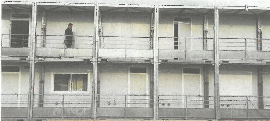
Des bâtiments temporaires sont en cours d'installation devant le collège. Les élèves suivront les cours dedans pendant un an. PH. AD.
